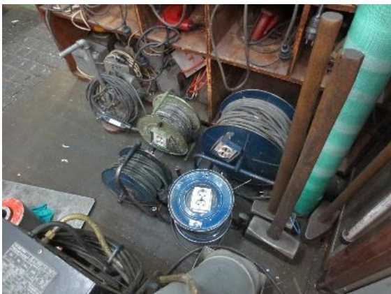
Slika 5: Neustrezni podaljševalni kabli
