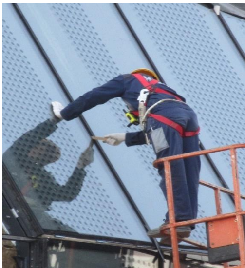
Slika 11: Nevarno izvajanje dela na višini
