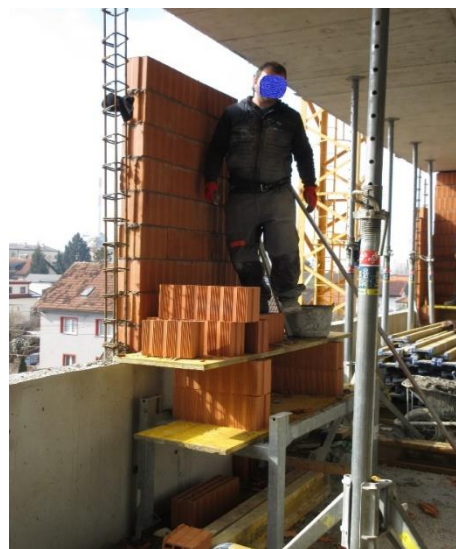
Slika 10: Neustrezno urejeno delovno mesto – improviziranje na gradbišču
