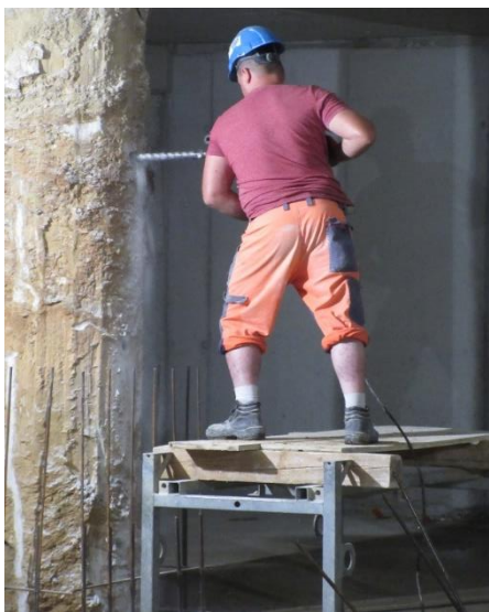
Slika 9: Neustrezno urejeno delovno mesto – improviziranje na gradbišču
