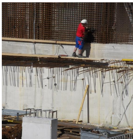
Slika 12: Nevarno izvajanje dela na višini
